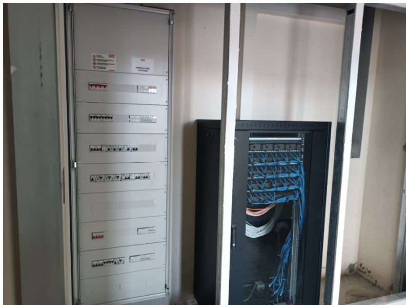
Figura 5: Locale tecnico per impianti telefonici e dati
